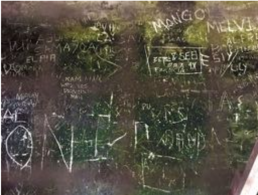
Figura 48.- Interior del Templo VI donde se puede apreciar el estado de deterioro del estuco que recubre las paredes interiores. Fotografía de la autora.
