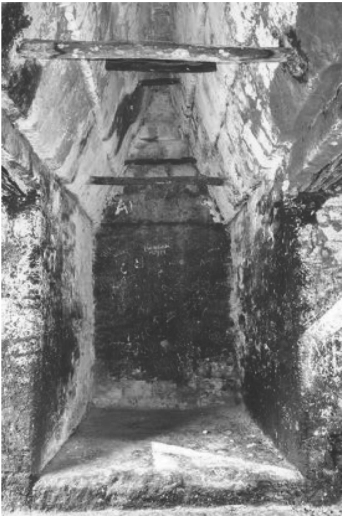
Figura 45.- Interior de la Estructura 5D-91 en el que se puede apreciar el estado de deterioro del estuco que recubre las paredes interiores. Fotografía de la autora.
