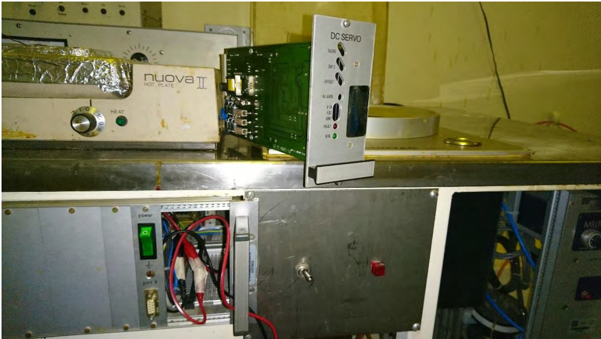
Figura 37. Sistema de deposición descompuesto
