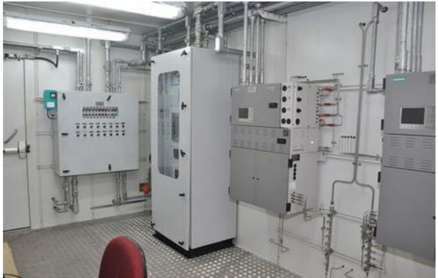
Figura 27 Shelter vista en el interior
