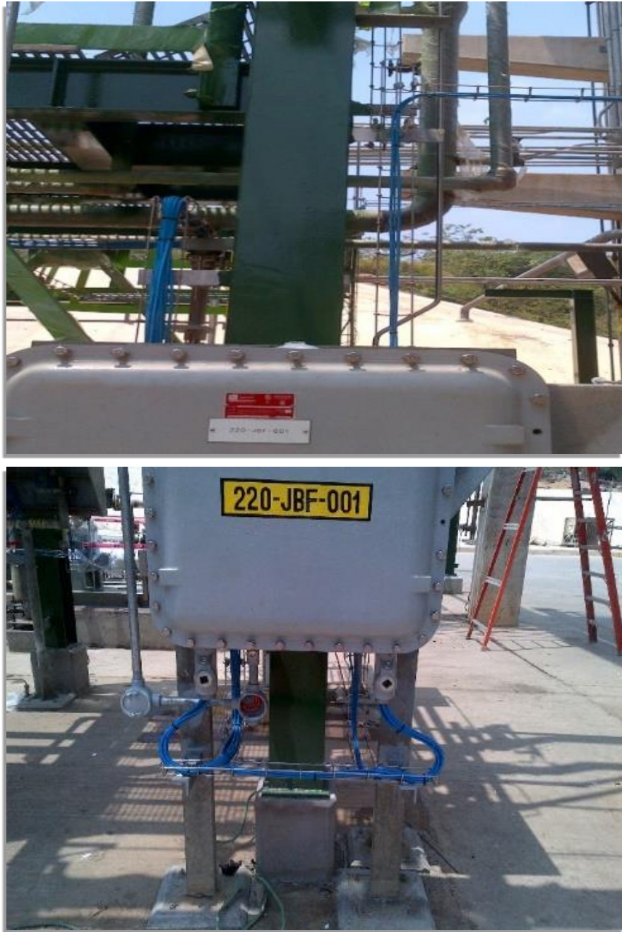
Figura 34 Cajas de conexión instalación en campo
