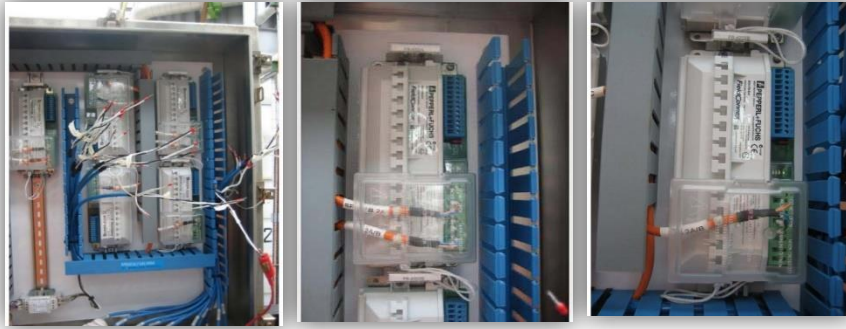
Figura 30 cajas de conexión
