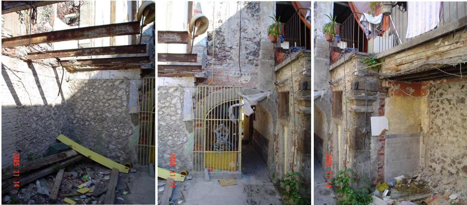
Ilustración 67. Vista bajo el pasillo colapsado en planta baja
