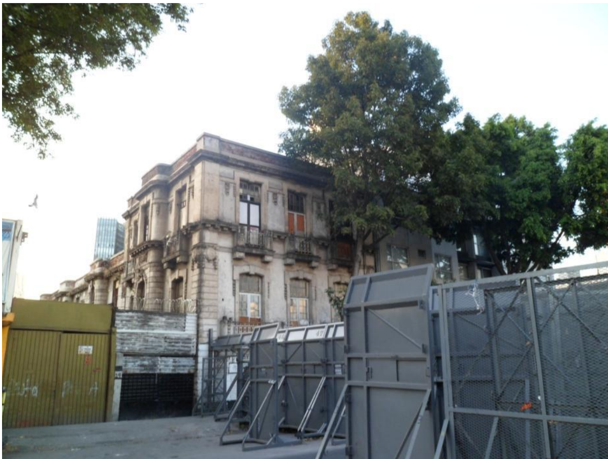
Inmueble catalogado por el INBA en la calle de Abraham González N° 29. Actualmente se encuentra abandonado. Fotografía tomada el Jueves 12 de noviembre del 2015 en sitio.
