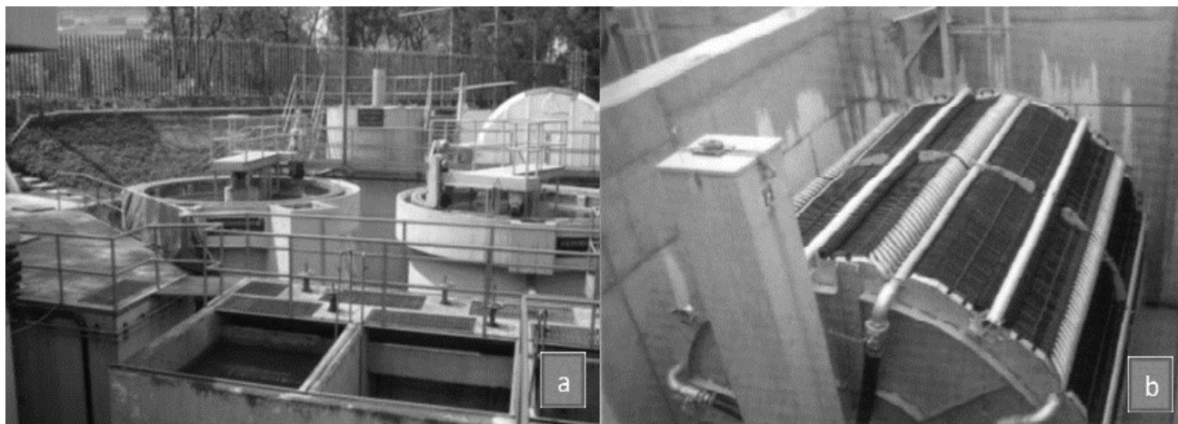
Imagen 3. a) Planta de tratamiento de aguas residuales de Cerro del Agua en la Ciudad Universitaria, de la UNAM (Ciudad de México), b) Biomembrana empleada en el tratamiento de aguas residuales de la planta
