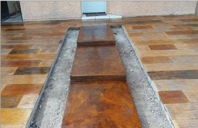
Ejemplo de concreto oxidado
