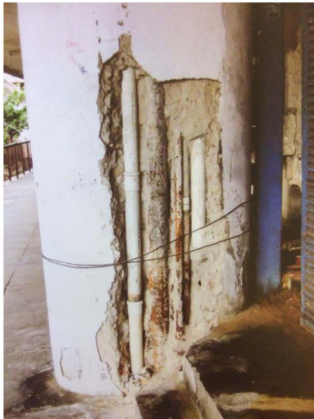
Figura 73: columna del Pedregulho antes de la restauración del 2011. La imagen evidencia el sistema constructivo en el que se ahogan las tuberías hidrosanitarias en los elementos estructurales de concreto armado. Imagen tomada de Brito Alfredo, "Pedregulho: o sonho pioneiro da habitação popular no Brasil". Pág. 114
