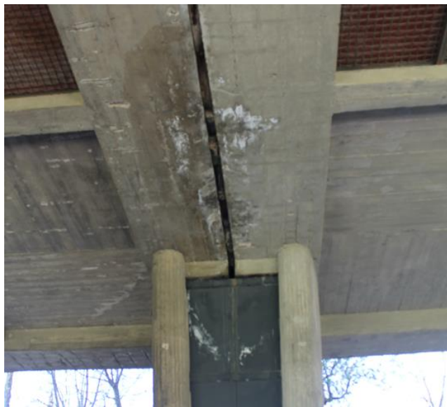
Figura 71: humedades en elementos estructurales de concreto armado en la unidad de habitación de Marsella. Fotografía del autor, marzo de 2014
