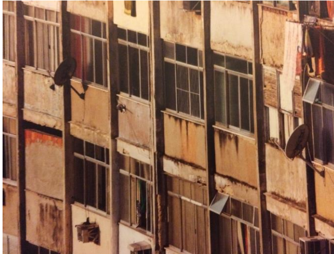
Figura 70: la cancelería original en las ventanas del Pedregulho presentaban serios deterioros; por lo que fue sustituida por completo en la restauración iniciada en el año 2011. Imagen tomada de Brito Alfredo, "Pedregulho: o sonho pioneiro da habitação popular no Brasil". Pág. 095
