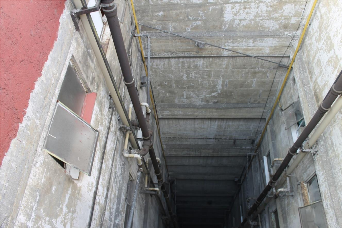
Figura 39: algunos de los problemas heredados de la administración del ISSSTE es la falta de mantenimiento a los cubos de iluminación y ventilación, presentan humedades, desprendimiento de aplanados e instalaciones obsoletas, difíciles de registrar o cambiar dado que están al vacío. Fotografía tomada por el autor, diciembre de 2013
