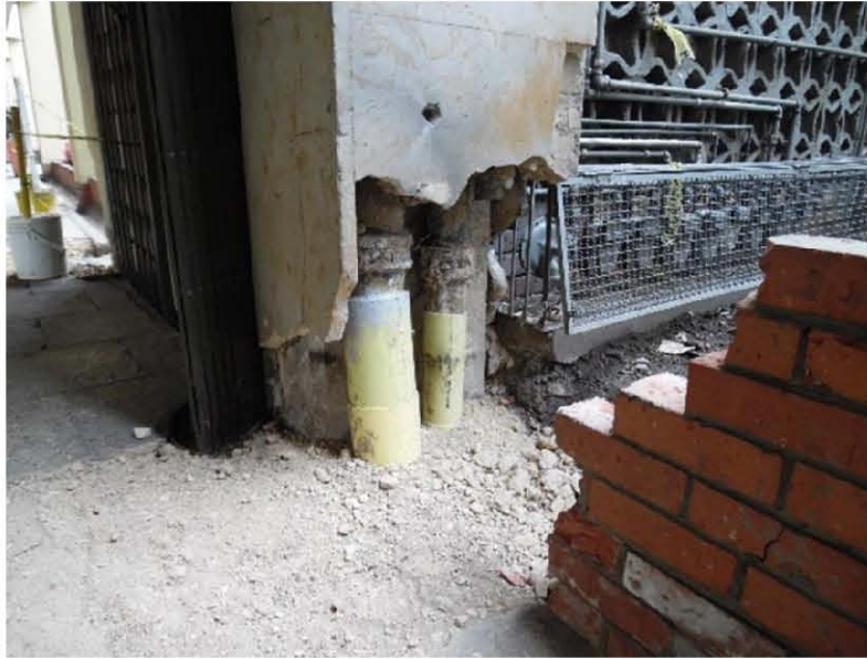
Figura 72: tuberías sanitarias ahogadas en muros divisorios de escaleras del CUAN, Fotografía del autor, marzo de 2015
