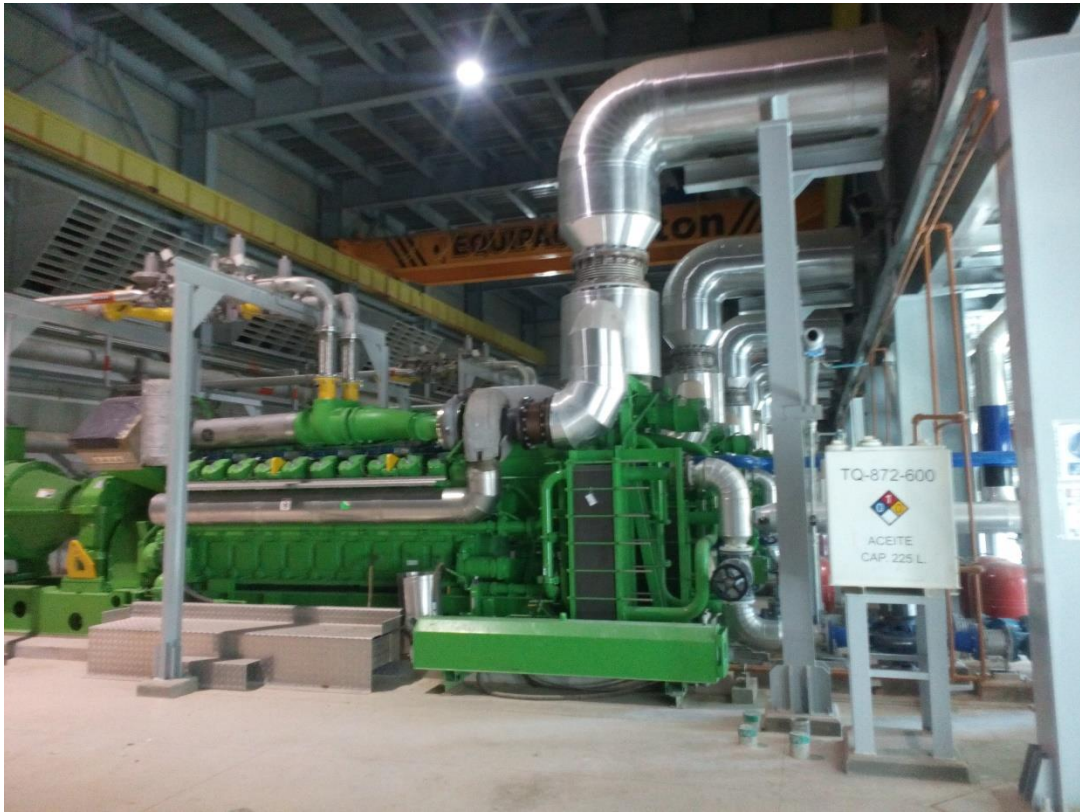
Figura 8. Sistema de cogeneración
