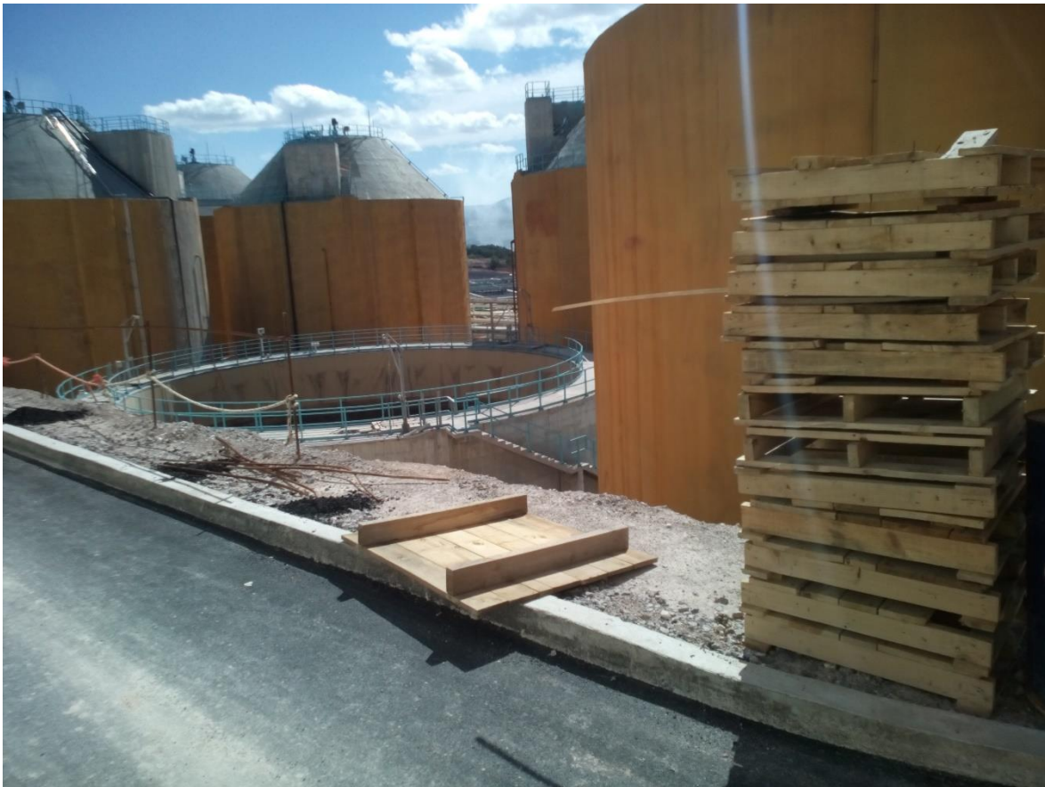
Figura 6. Biodigestores de Lodos primarios y secundarios
