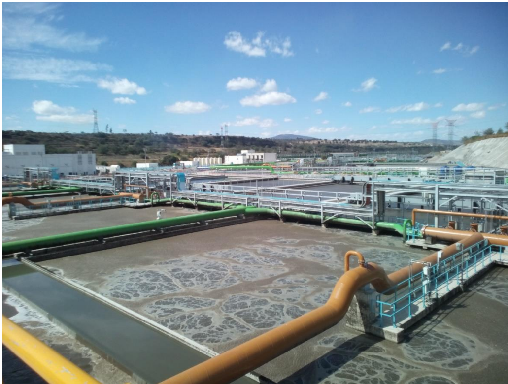
Figura 5. Reactores de Lodos Activados.
