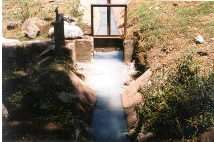
Fotografía N° 2 Contaminación en canaletas de riego.
