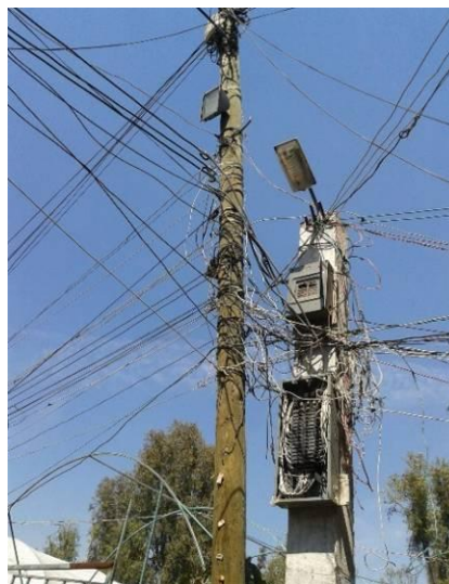
3.15.b. Cableado de toma irregular de energía eléctrica, Tiras de Zacapa
