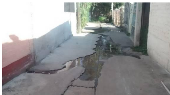
3.11.b. Desagüe de agua gris al aire libre, Barrio Caltongo
