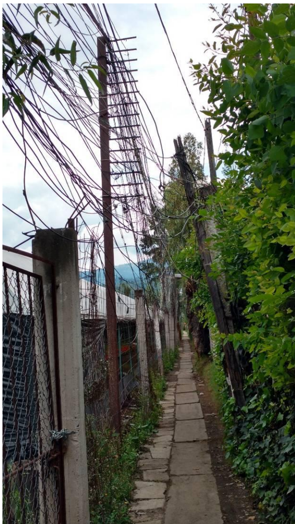
3.15.a. Cableado de toma irregular de energía eléctrica, Tiras de Zacapa
