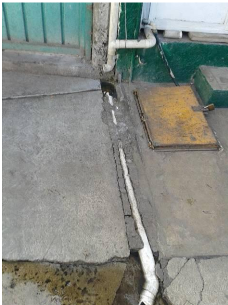
3.13.c. Desagüe individual de agua gris, Barrio Caltongo
