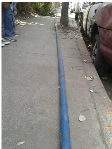
3.9.a. Manguera de desazolve desde vivienda, Barrio Caltongo
