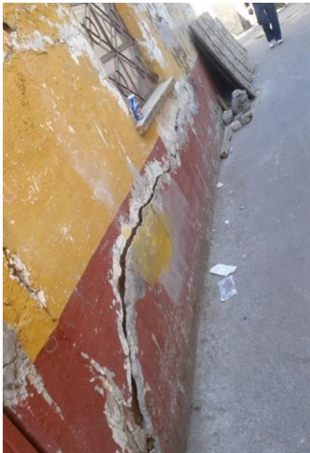
3.3.a. Agrietamiento de pared en vivienda, Barrio Caltongo
