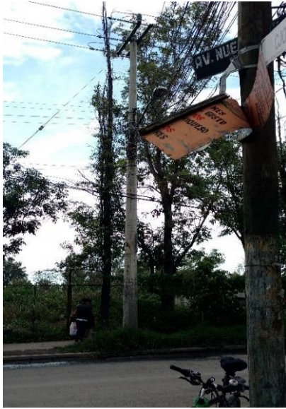
3.16.a. Toma irregular de energía eléctrica desde la postería de avenida Nuevo León, Tiras de Zacapa
