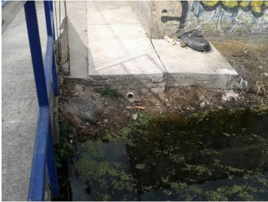
3.13.e. Desagüe colectivo de agua gris en canal, Ampliación Caltongo
