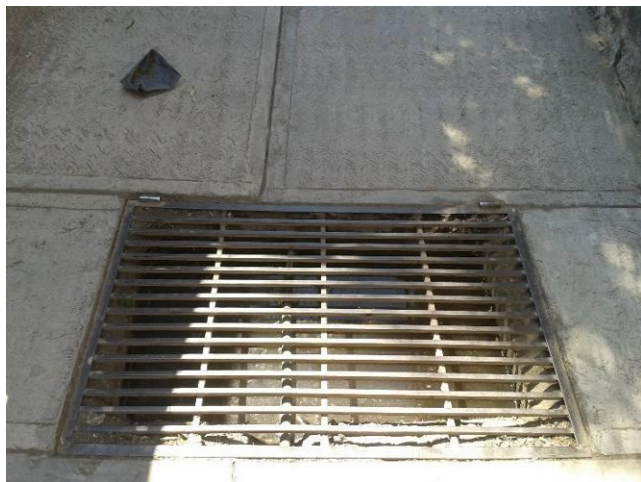
3.13.d. Desagüe colectivo de agua gris, Barrio Caltongo
