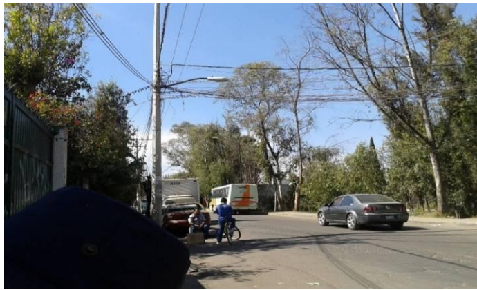
3.16.b. Toma irregular de energía eléctrica desde la postería de avenida Nuevo León, Barrio Caltongo
