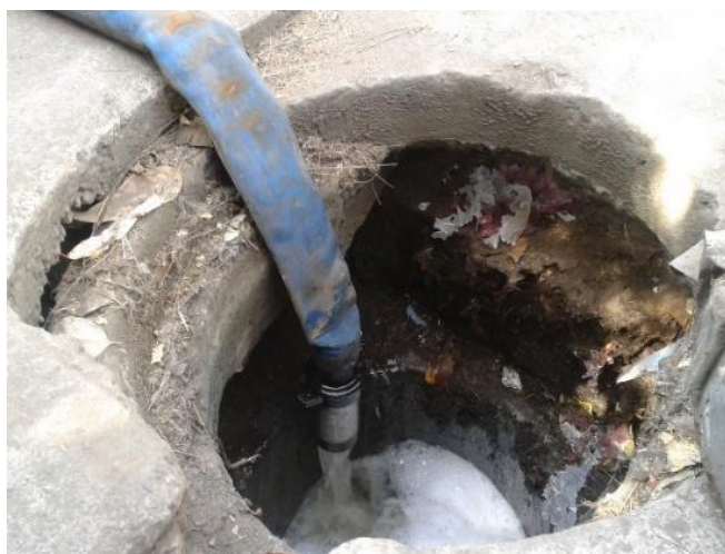
3.9.b. Desagüe de agua residual de vivienda en drenaje público, Barrio Caltongo
