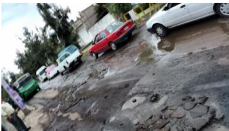
Imagen 3.22. Deterioro de pavimentación en la avenida Nuevo León
