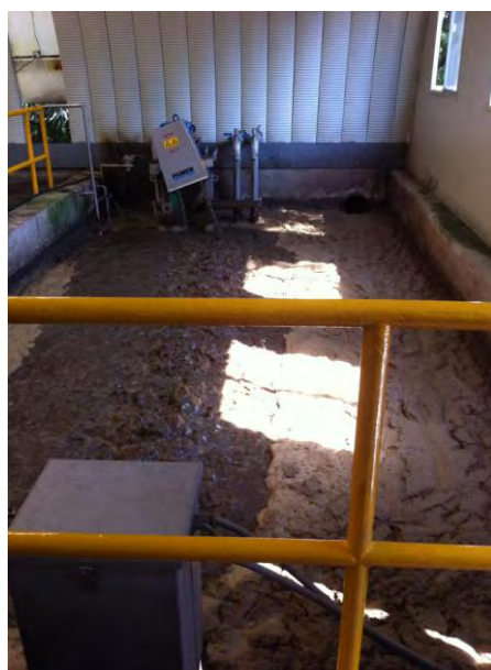
Figura 3-1. Tanque de membranas de la PTAR de CU.
