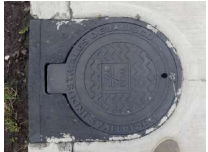
Figura 45: Fotografía de los registros de agua potable. Fuente: Autoría propia (2015)
