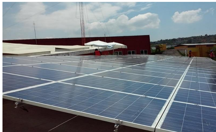
Fig. 3.6. Sistema fotovoltaico interconectado a la red en las instalaciones del CeMIAgro.
