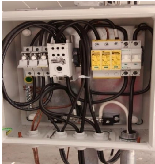
Fig. 3.7 Caja de combinación de los arreglos fotovoltaicos del sistema
