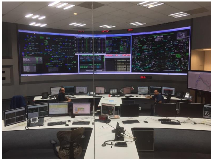
Figura 4.3. Centro Nacional de Control de Energía (Junio 2015).
