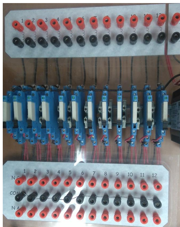
Imagen 41. Banco de relevadores
