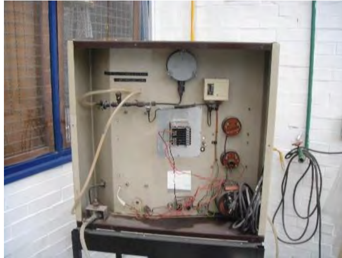
Figura 10 Cableado dentro del equipo, parte posterior.
