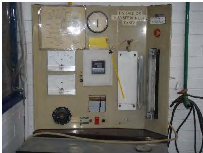
Figura 11 Equipo en donde se puede apreciar que varios dispositivos faltan.
