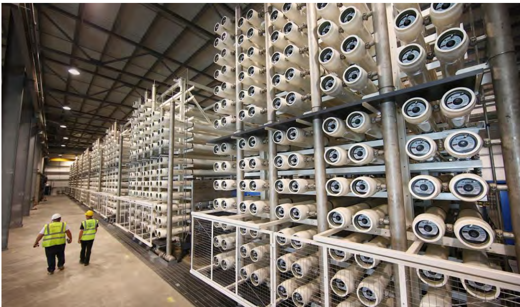
Imagen 27. Los cartuchos (membranas) de Osmosis Inversa de la Planta en Beckton. Wikipedia.org
