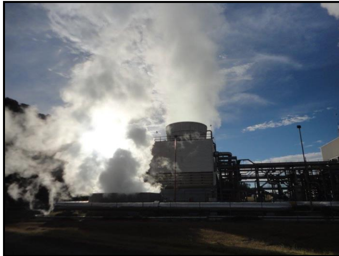
Figura 1.2. Central Geotérmica. Los Azufres, Michoacán (Tomado del Curso de Exploración Geotérmica, 2014).
