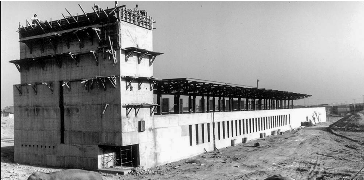
La Fábrica de Artes y Oficios de Oriente, conocida como el FARO de Oriente, durante la etapa de construcción. Fotografía del Archivo TAX.
