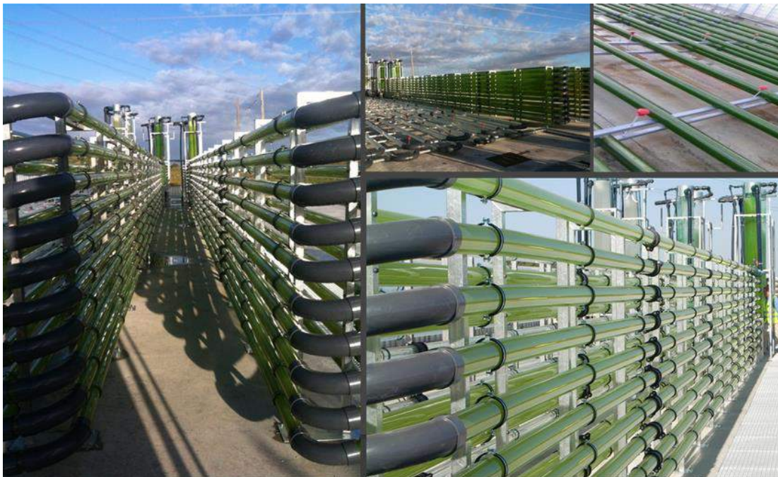
Fig.17. Planta Industrial Arcos, España. Diseño de Fotobioreactores tubulares horizontales. Recuperado de (AlgaEnergy 2014).
