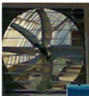
Figuras 3.3 Etapa de enfriamiento por medio de extractores.
