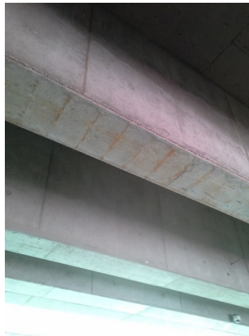
Figura 2.3 Manchas por oxido, Centro Cultural la Moneda en Santiago, Chile.
