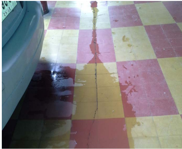
5.17 Grietas en piso de pasillo de planta baja
