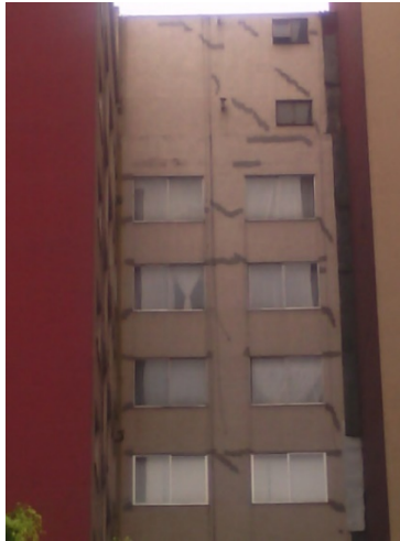
Figura 2.1 Fisuras de cortante, edificio de la Cd. de México
