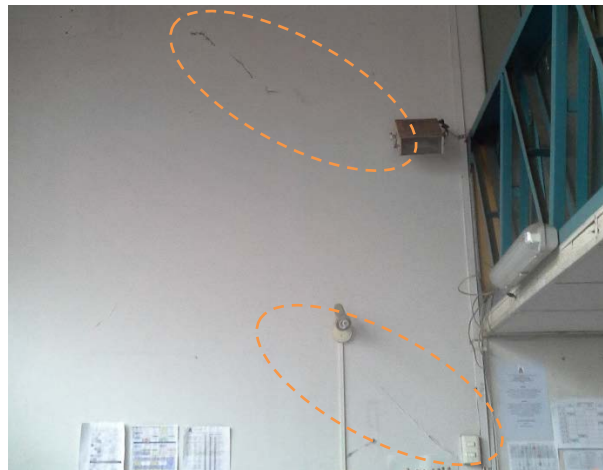
5.18 Fisuras y grietas en sala de maestros
