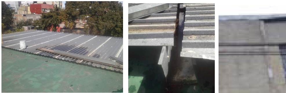
Figura 5.31 Lesiones en cubierta del Gimnasio
