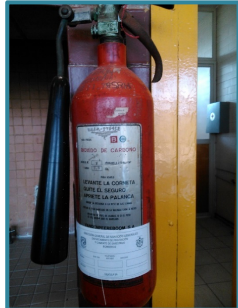
Fig. 16 Extintor típico de CO 2 en los laboratorios.
