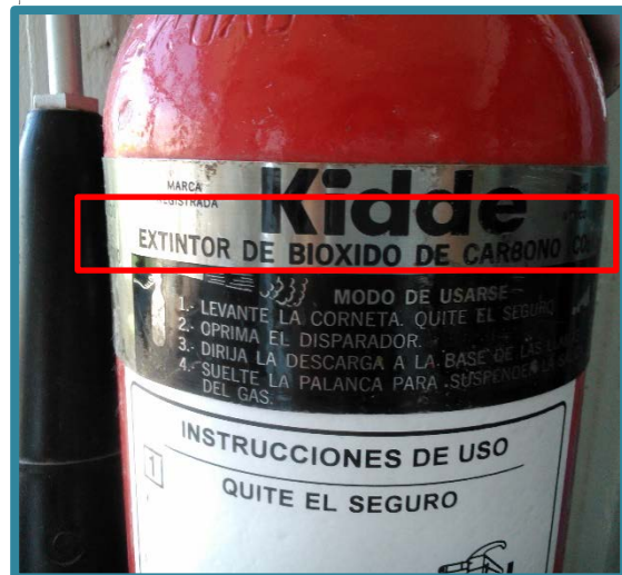
Fig. 17 Extintor típico de CO 2 en los laboratorios.
