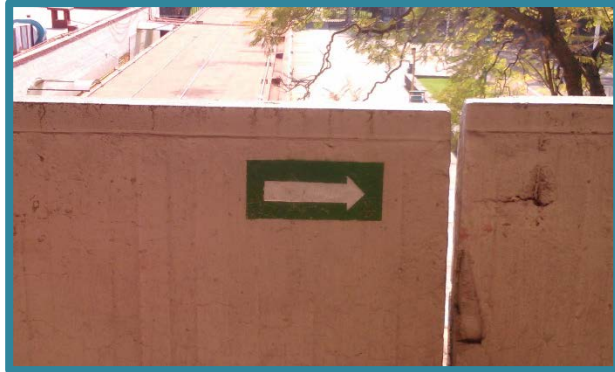
Fig. 20 Señalización típica existente que indica el sentido de la ruta de evacuación en el edificio A.
