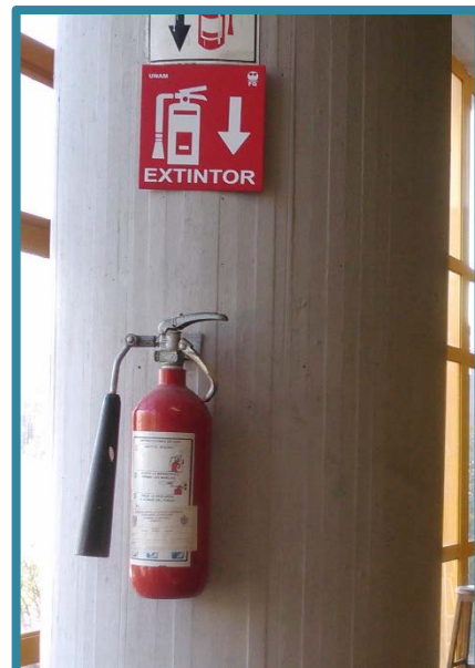
Fig. 16 Extintor típico de CO 2 en los laboratorios.
