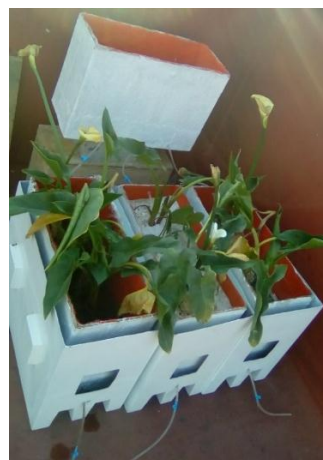
Figura 21.- Instalación completa de los tres módulos de humedales artificiales tras la segunda etapa de montaje. Fotografía de realización propia.
