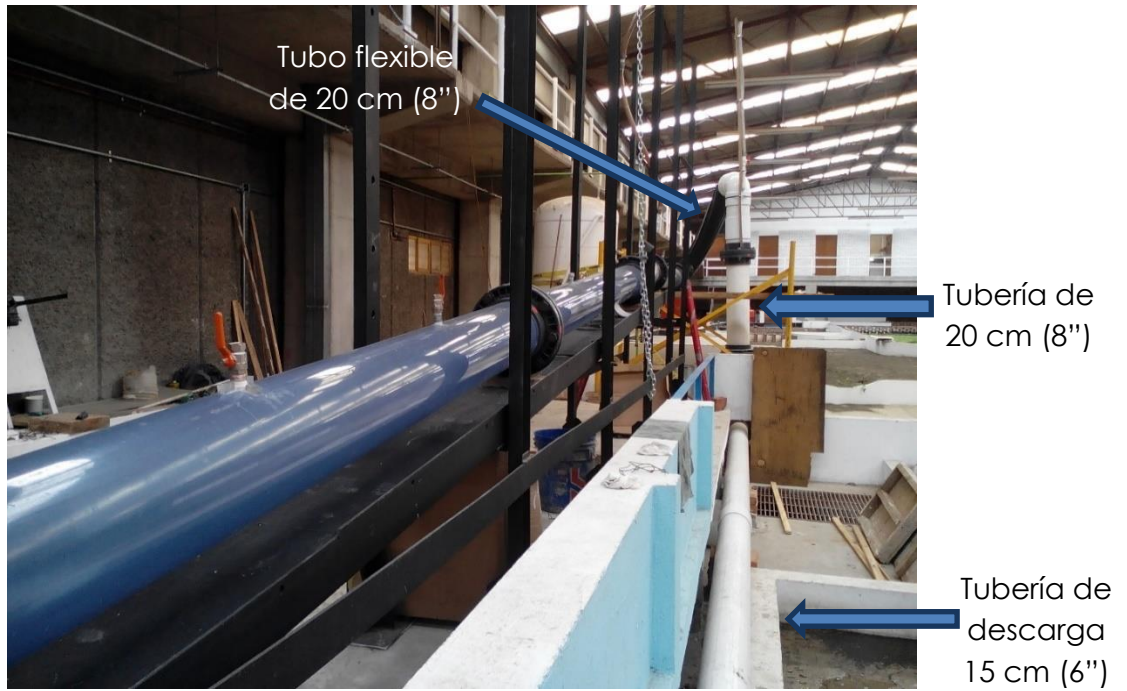
Figura 4. 5. Tubería de conducción
