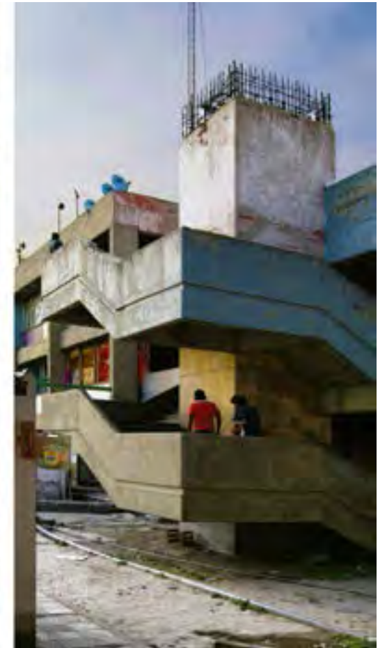
Las escaleras del predio okupado, vemos la estructura inacabada y un escenario muy diferente al de una escuela. Se notan rastros de pintura de hace varios años.
