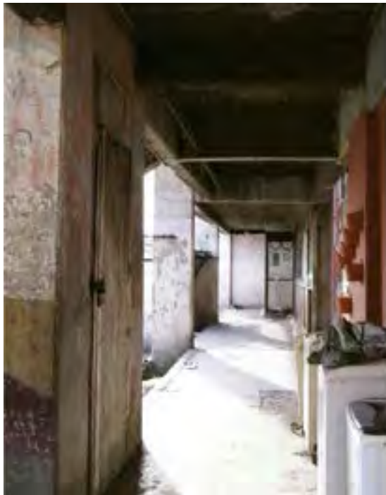
Pasillo que conecta un edificio con otro, es visible la falta de acabados y la ausencia de mantenimiento, desde su construcción hasta el periodo de okupación.
