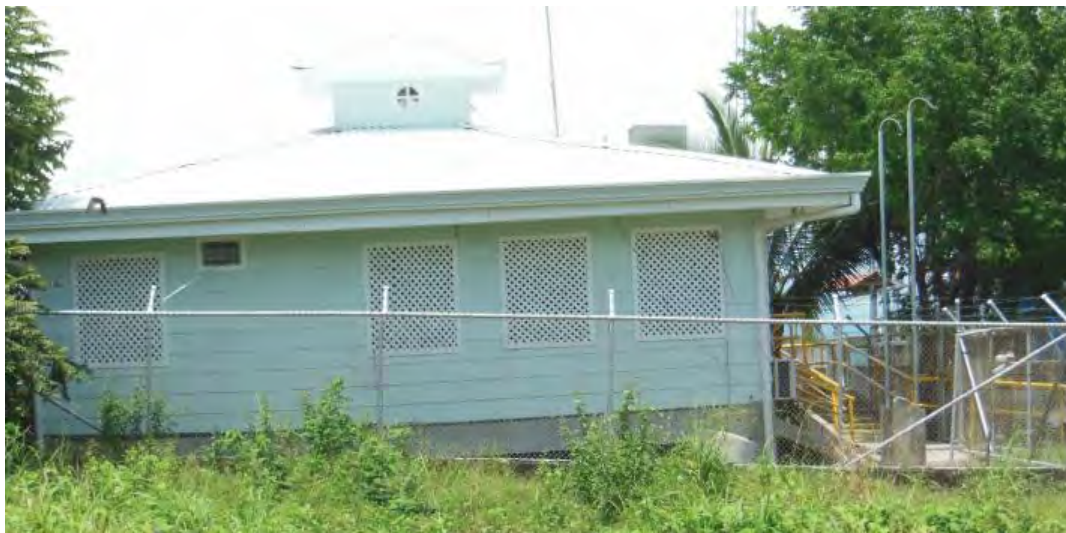
Fig 2.58 Asentamiento diferencial (entre 50 y 75 cm) del edificio de la Capitanía del Puerto (GEER Association, 2013)
