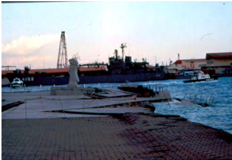
Fig 2.12 Hundimiento y desplazamiento horizontal en muelle, debido a licuación (National Platform for Natural Hazards, 2015)
