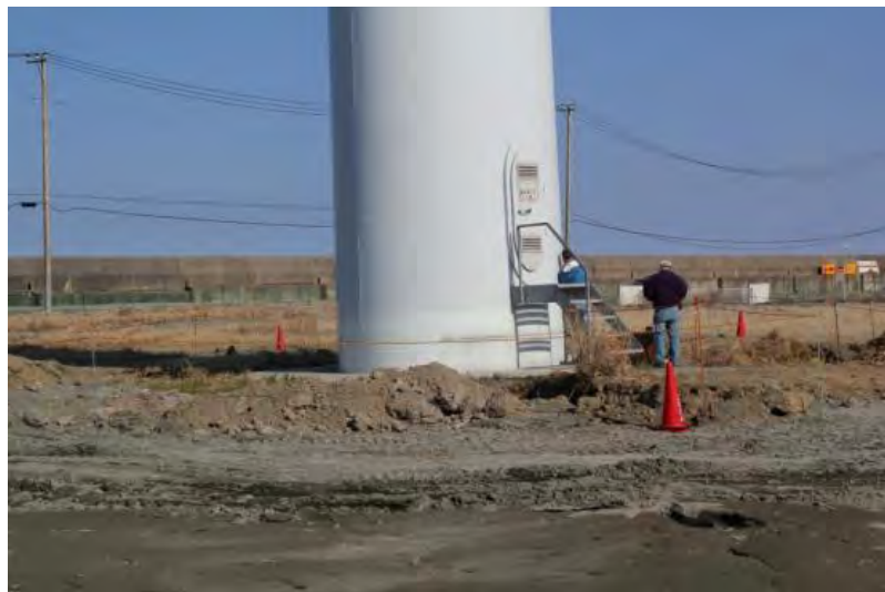
Fig 2.56 Turbina eólica con inclinación de 1.6° (GEER Association, 2011b)
