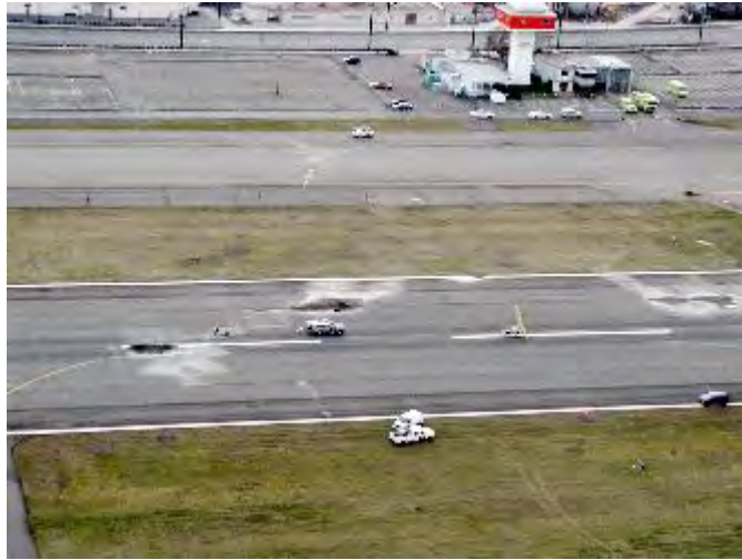
Fig 2.21 Vista aérea del extenso daño ocasionado, sobre la pista se observan sismitas y arena que emergió (Pacific Earthquake Engineering Research Center-PEER, 2015)
