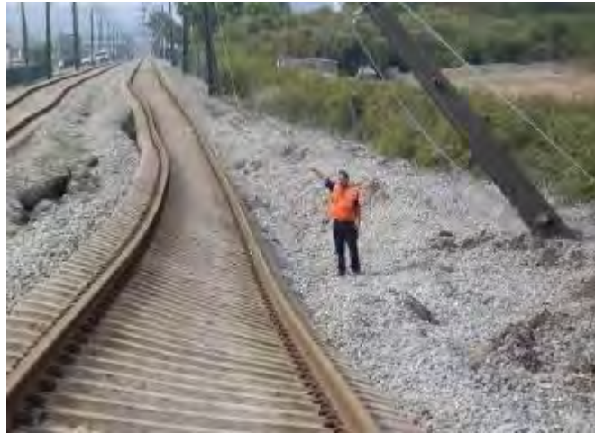
Fig 2.34 Vías férreas con asentamiento y desplazamiento lateral (Verdugo, 2012)
