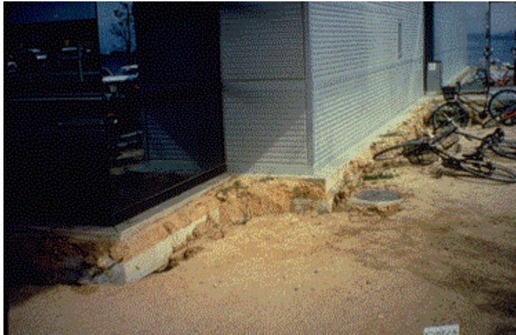
Fig 2.15 Asentamiento de cerca de 30 cm alrededor de la terminal del ferry en Isla del Puerto (GEER Association, 1995)
