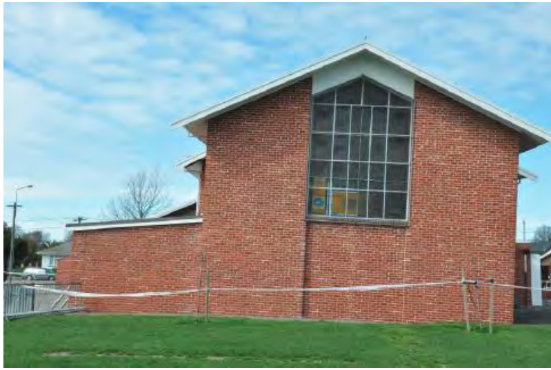
Fig 2.44 Inclinación y asentamiento en la iglesia de St. Paul (GEER Association, 2010c)
