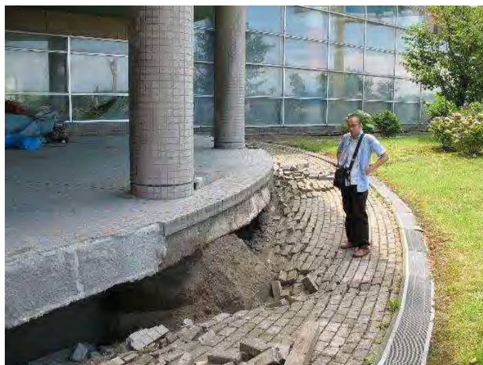
Fig 2.27 Edificio con leve inclinación y presencia de licuación en terreno adyacente (Global Risk Miyamoto, 2007)
