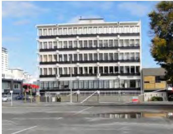
Fig 2.50 Edificio con asentamiento diferencial de hasta 29 cm (GEER Association, 2011a)
