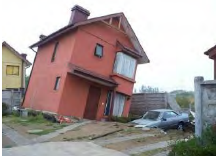
Fig 2.32 Casa de un par de niveles con desplazamiento lateral y asentamiento diferencial ocasionados por el suelo licuado (Verdugo, 2012)
