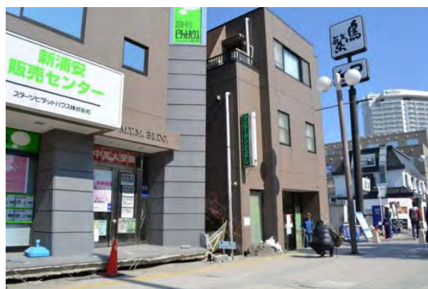
Fig 2.53 Acera con asentamiento de al menos 30 cm, el edificio de la derecha sufrió asentamiento diferencial e inclinación (GEER Association, 2011b)
