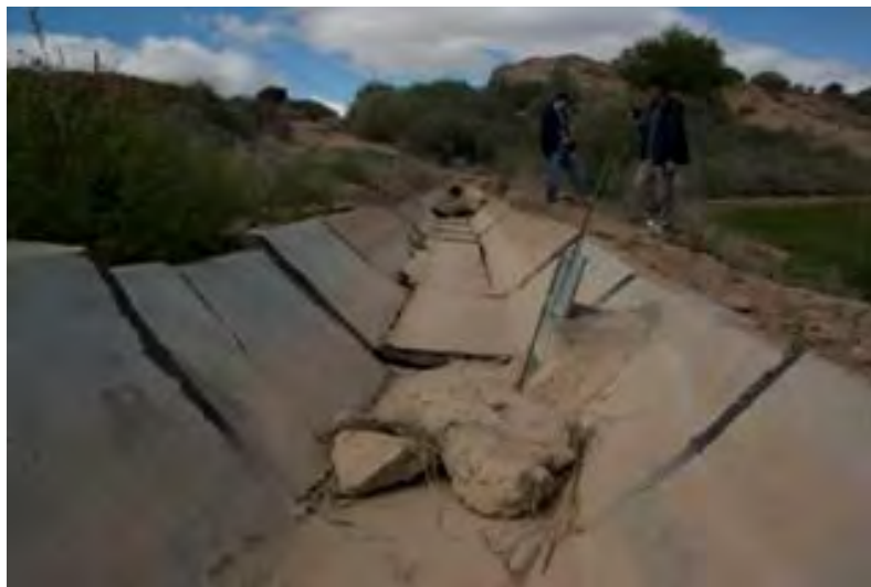
Fig 2.40 Canal de riego con daño grave ocasionado por desplazamiento lateral del suelo (GEER Association, 2010b)
