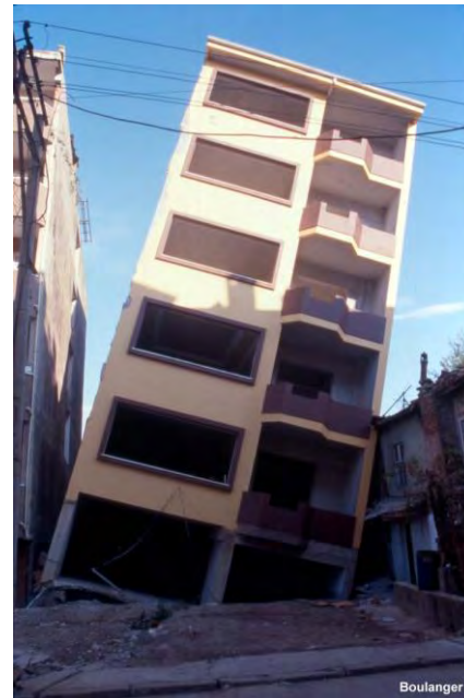
Fig 2.17 Edificio de reciente construcción inclinado; no presenta daño en superestructura (University of California, Davis campus, 2015)
