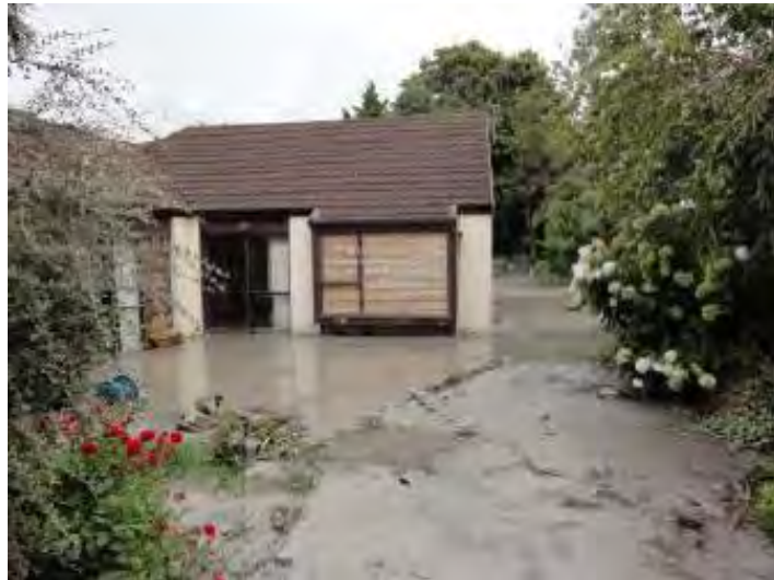
Fig 2.47 Casa en Kaiapoi con asentamiento de 40 cm producto de la licuación del suelo, a su alrededor se observa gran cantidad de material eyectado (GEER Association, 2011a)
