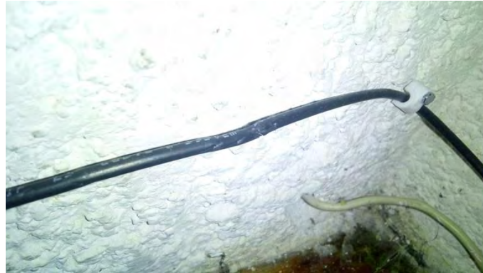
Figura 43. Cable de fibra óptica roto
