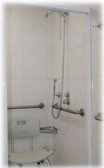
Regadera para discapacitados, con todas las adaptaciones con las que pueda estar cómodamente realizando su aseo personal.
