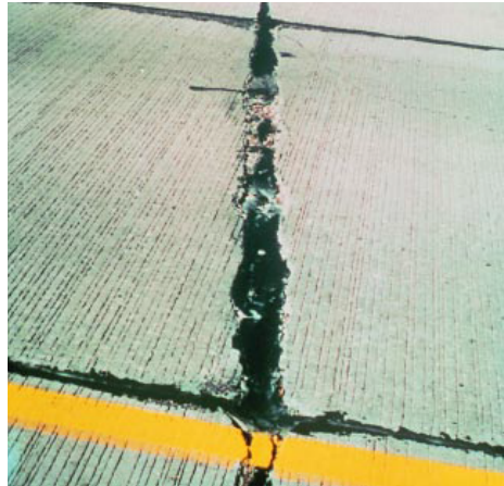
Imagen 2.6.- Daño ocasionado por enfriamiento en una junta de pavimentos
