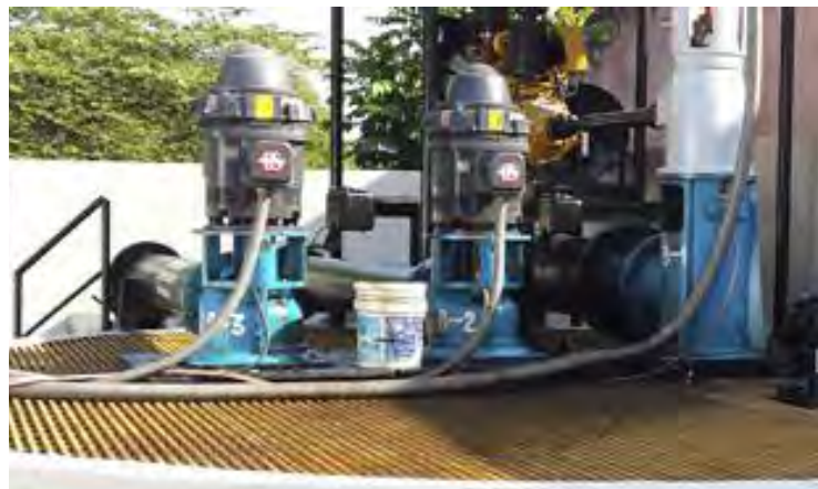
129. Carcamo de bombeo
