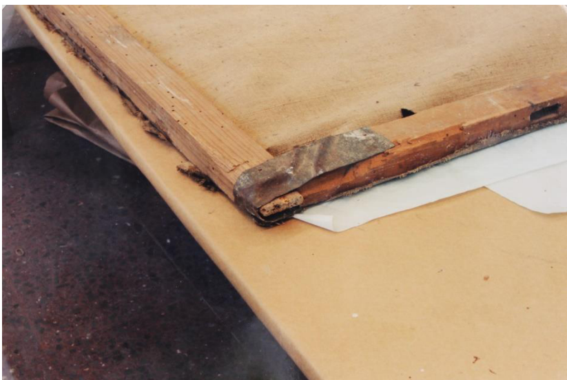
Fig. 101 En la imagen se aprecia una caja innecesaria en el larguero izquierdo, además de la unión de éste con el cabezal inferior mediante una lámina pues no cuenta con ensamble. Tomado de Sergio González García, Informe sobre los trabajos de restauración realizados en la obra "Presentación de la Virgen al templo" del pintor José de Ibarra (1688- 1756) , México, ENCRyM- INAH, 2000, s/p.
