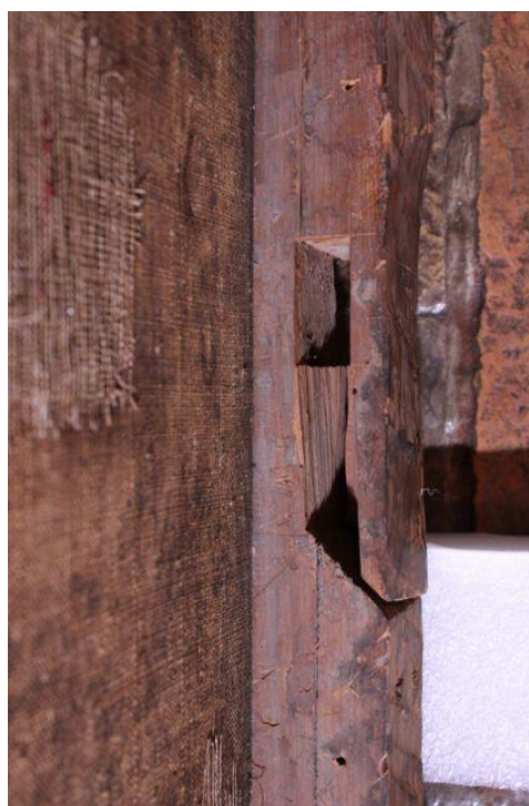
Fig. 149 En la imagen se aprecia la caja horadada en el larguero derecho, así como una rotura en el ensamble que une a las dos secciones de ese miembro. Fotografía de Carlos García Silva.
