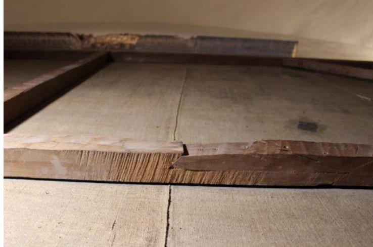
Fig. 136 Detalle del ensamble de media madera en diagonal, reforzado con taquetes, usado para unir las dos secciones que conforman el travesaño horizontal. Fotografía Elizabeth Vite.
