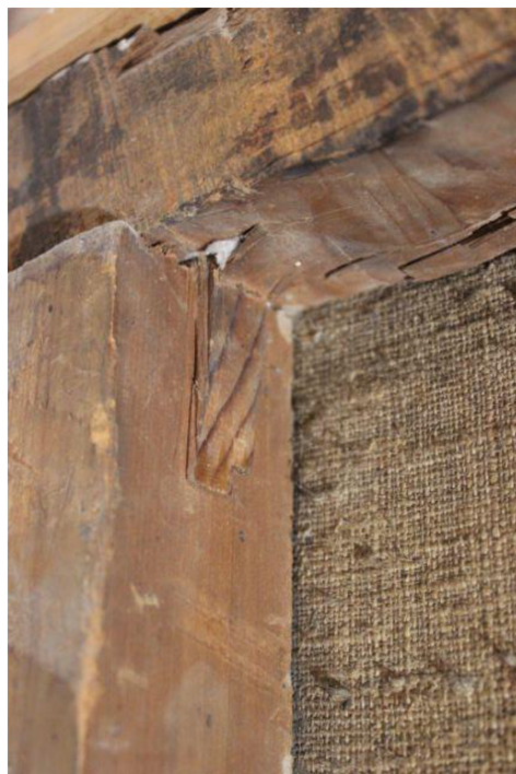
Fig. 140 Unión entre el travesaño vertical y el cabezal superior. Fotografía Elizabeth Vite.
