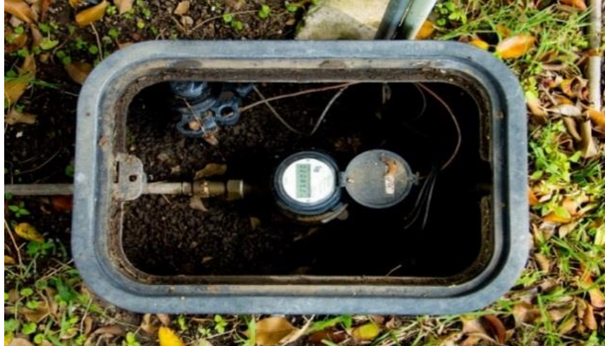
Figura 14: Medidor volumétrico instalado en la entrada del tanque de almacenamiento del edificio 19, perteneciente al centro de capacitación.
