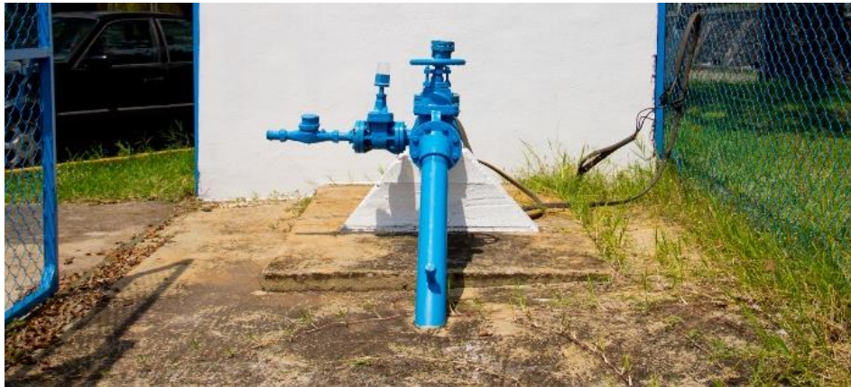
Figura 30: Infraestructura de la fuente de abastecimiento de la red de agua potable.
