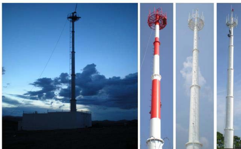
Figura 7.18 Torre tipo monopolo.
