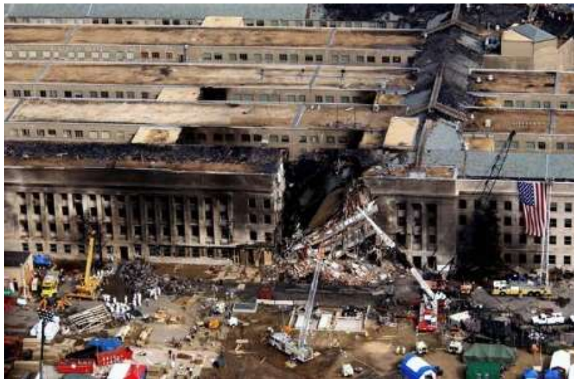
Imagen 3.18 Fotografía donde se observa la fachada del Pentágono en Virginia después del impacto de un tercer avión secuestrado durante los atentados terroristas del 11 de septiembre en 2001. Fuente: http://www.cubadebate.cu/opinion/2011/09/11/11-de-septiembre-caras-del-terrorismo-en-estados-unidos/ .
