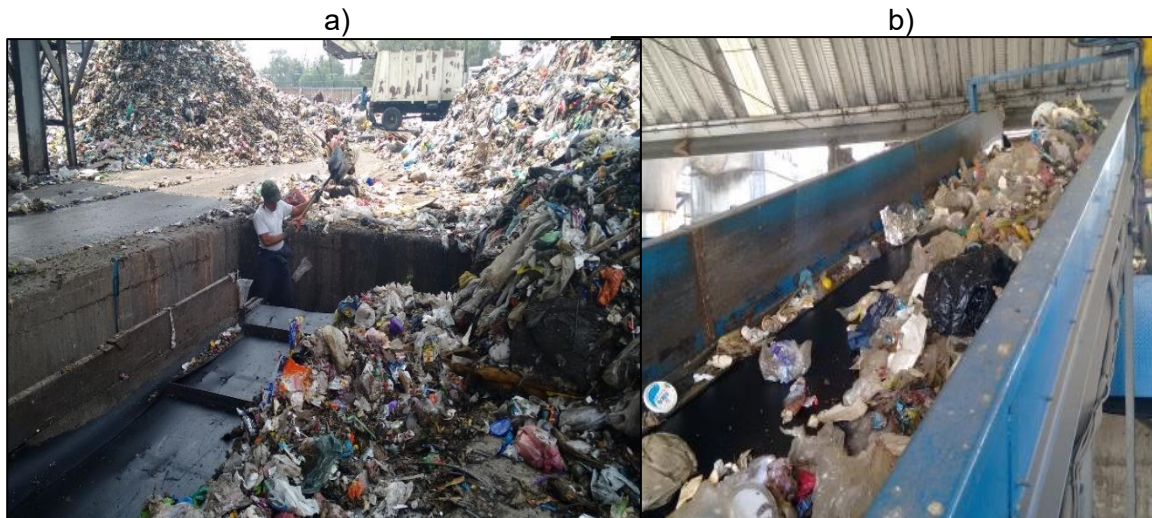
Figura 5.26 Fosa de depósito (a) y banda inicial de transporte de residuos (b) Fuente: (Elaboración propia)
