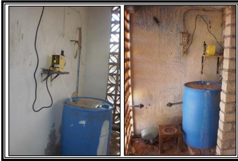
Foto 5.5. Equipos de dosificación instalados en los tanques Leona Vicario y pozo Rancho Viejo
