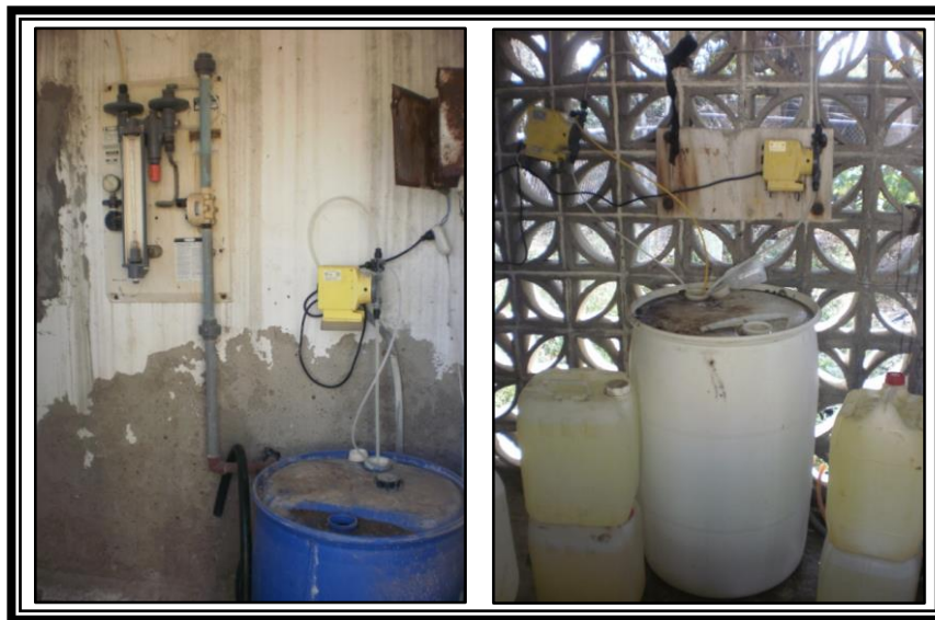
Foto 5.6. Equipos de dosificación instalados en los pozos Chirimoyo y Los Hervideros
