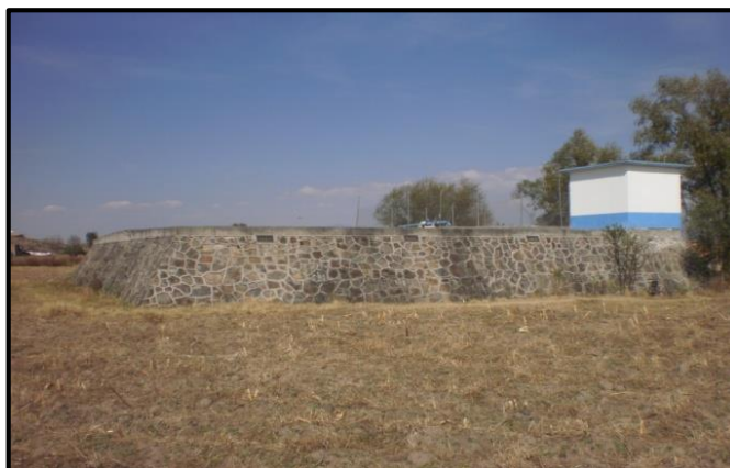
Foto 5.3. Tanque de regularización Santa Rita – Quinto Cuartel
