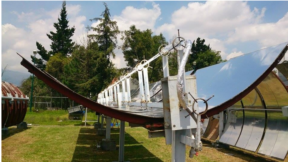
Figura. 1.4 Reactor cilindro parabólico instalado en la planta solar del Instituto de Ingeniería en la UNAM.
