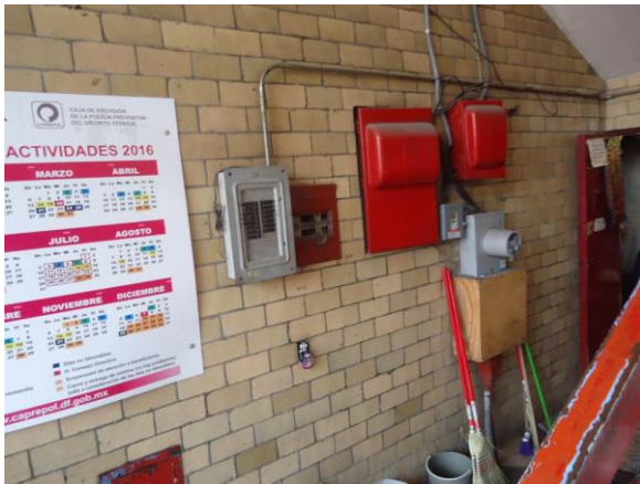
Zona de tableros eléctricos.
