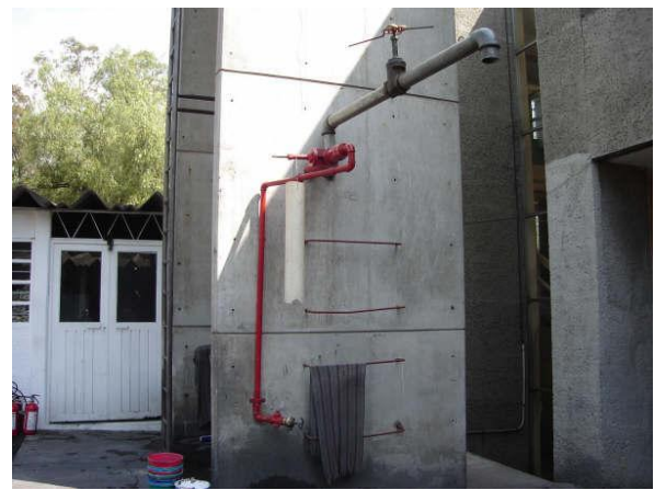
La Estación cuenta con un tanque elevado de 10\text{m}^3 de capacidad con el cual abastecen de agua a las unidades de emergencia y cumple adicionalmente la función de secado de mangueras.
