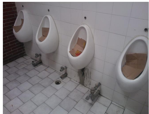
Sanitarios fuera de servicio.
