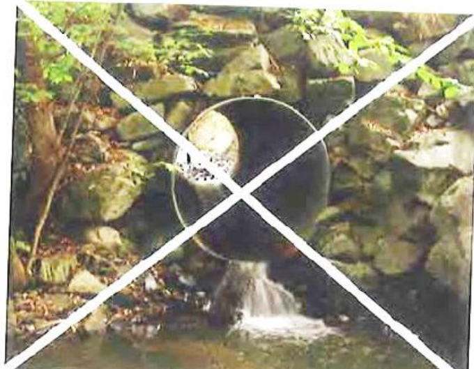
Fig. 4-60 Ejemplo 3 de malas prácticas: Este drenaje en Noruega tiene dos problemas simultáneos: Su salida tiene un nivel demasiado alto en relación al curso fluvial, dicho desnivel supone una barrera para los peces que se dirigen aguas arriba. El segundo problema es la baja altura de la lámina de agua, lo cual sugiere una trampa mortal para los peces que se dirigen aguas abajo. Foto: B. Iuell
