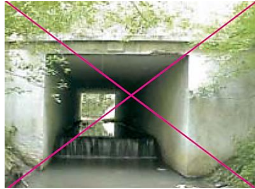
Fig. 4-61 Ejemplo 5 de malas prácticas: Escalón en el interior del drenaje que supone un obstáculo para el movimiento de fauna acuática. Foto: J. Dufek.
