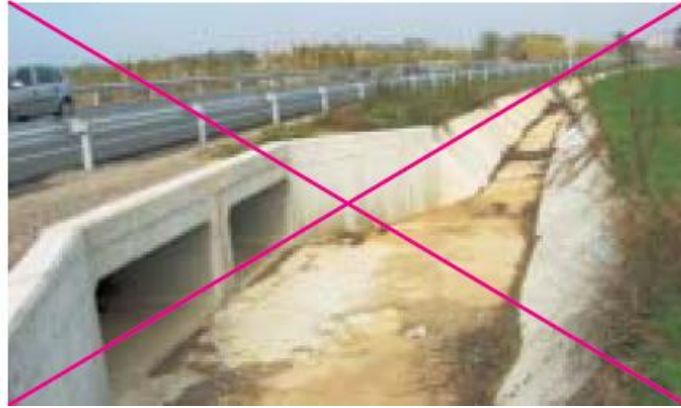
Fig. 4-54 Ejemplo 2 de malas prácticas: las paredes de la acequia dificultan el retorno de los animales al entorno. Foto: F. Navàs.
