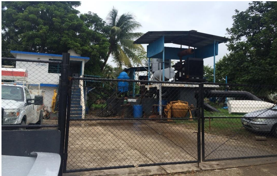
Fotografía 4. Cárcamo en operación ubicado en la localidad Bosque de Saloya, Nacajuca, Tabasco. Dicho cárcamo es activado cuando el nivel de agua del vaso regulador (o conocido como la laguna “La lima”) ha sobrepasado de su nivel ordinario.
