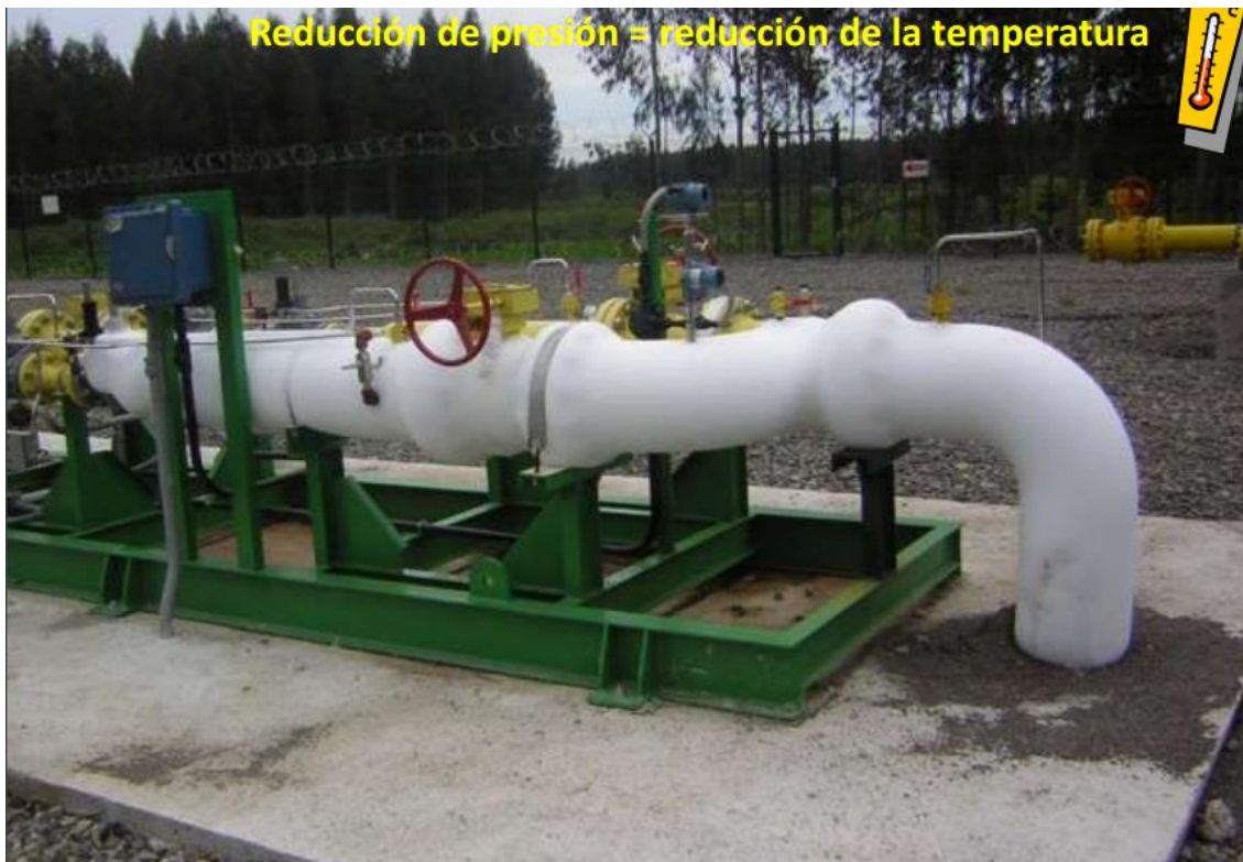
Figura 2-4. Congelamiento de la Tubería Presentación del Jefe de Operación y Mantenimiento Ing. Jorge Gonzalez Galindo
