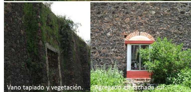
Foto 5,6 y7. Deterioros en las fachadas exteriores de la troje, se aprecia la problemática generada por la vegetación. Fotografía: NCRG/ 11-08-2014.
