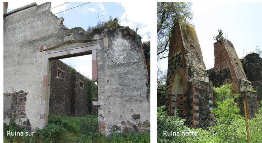
Foto 29 y 30. Ruina de la fachada (izq) y contrafuertes (der). Fotografía: NCRG/ Fotografía: NCRG/ 23-10-2015.
