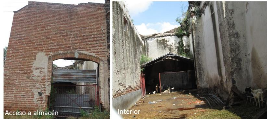
Foto 27 y 28. Estado actual del almacén anexo a la troje. Fotografía: NCRG/ Fotografía: NCRG/ 23-10-2015.
