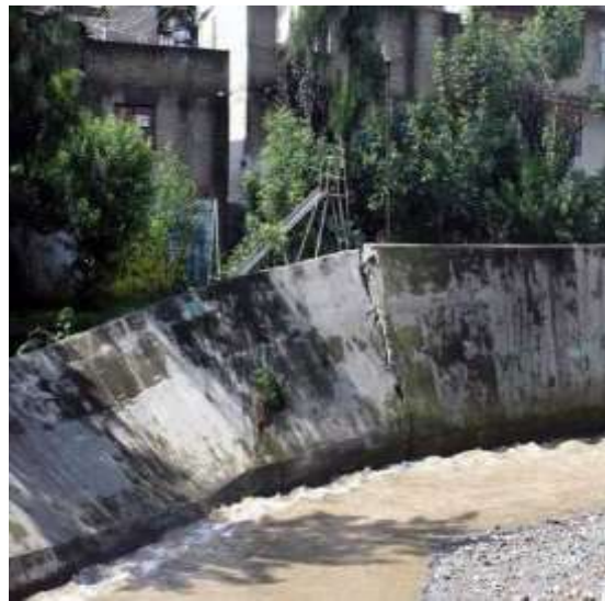
Fig. 1.11 Muro colapsado junio año 2014.
