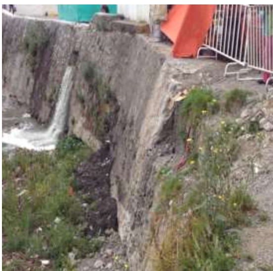
Fig. 1.8 Descarga Sanitaria a cauce del río.
