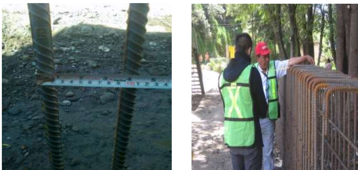
Fig. 2.1 Comprobación, verificación y revisión de trabajos ejecutados. (Habilitado y armado de acero de refuerzo)
