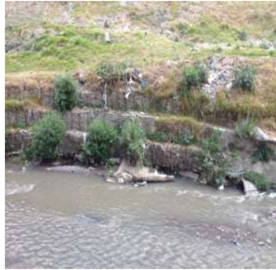
Fig. 1.7 Presencia de socavaciones.
