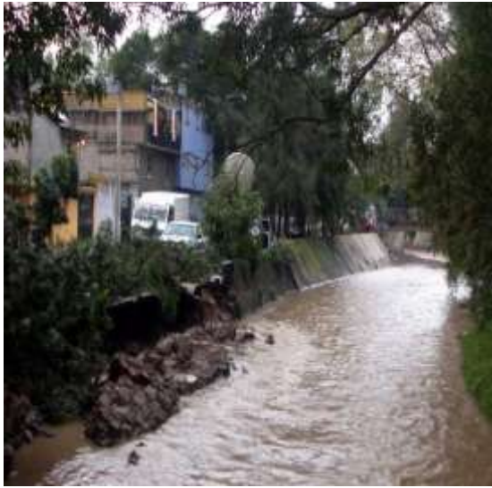
Fig. 1.6 Muro de mampostería colapsado
