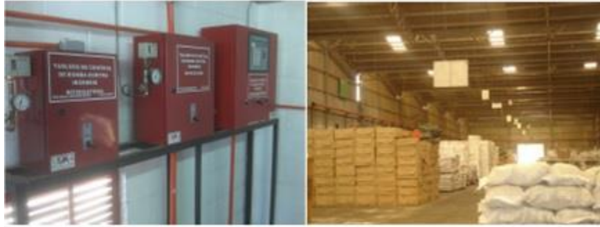
Figura. 7 Fotos de almacén y panel de control [16].
