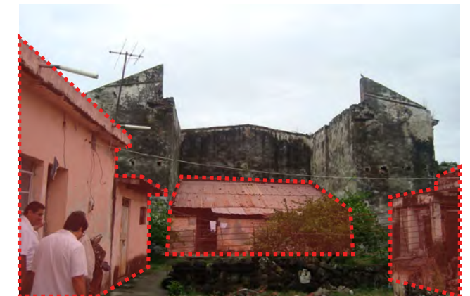
Vivienda precaria adosada a la caja escénica del Antiguo Teatro Aurora.
