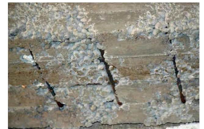
Corrosión de refuerzos estructurales expuestos a causa de un mal vibrado del concreto.
