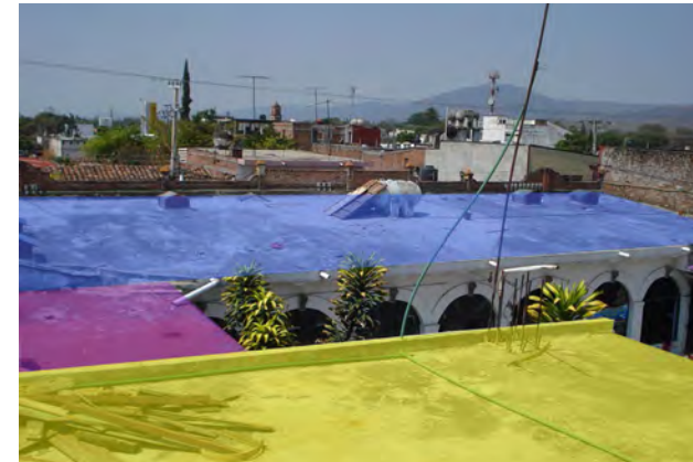
Agregado que cegan parte de los intercolumnios de una arcada existente.
