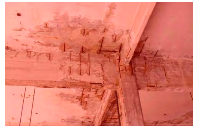
Corrosión de refuerzos estructurales expuestos.
