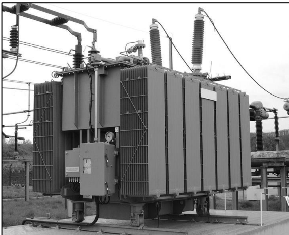
Figura (7.2) Transformados de potencial
