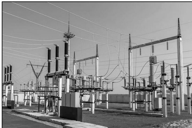
Figura (7.1) Ejemplo de una subestación eléctrica.
