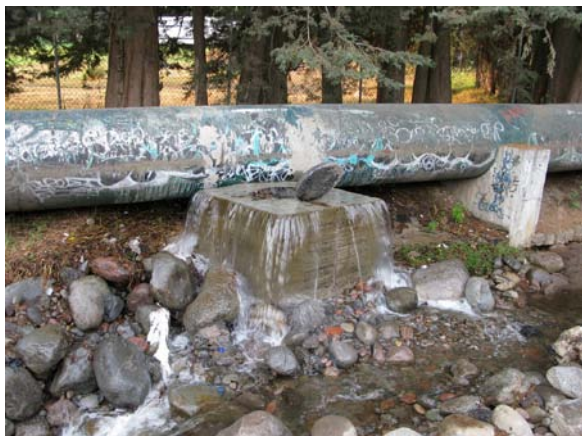
Fotografía que muestra el caudal del sistema de drenaje supereditado por el flujo de aguas pluviales y de aguas negras.
