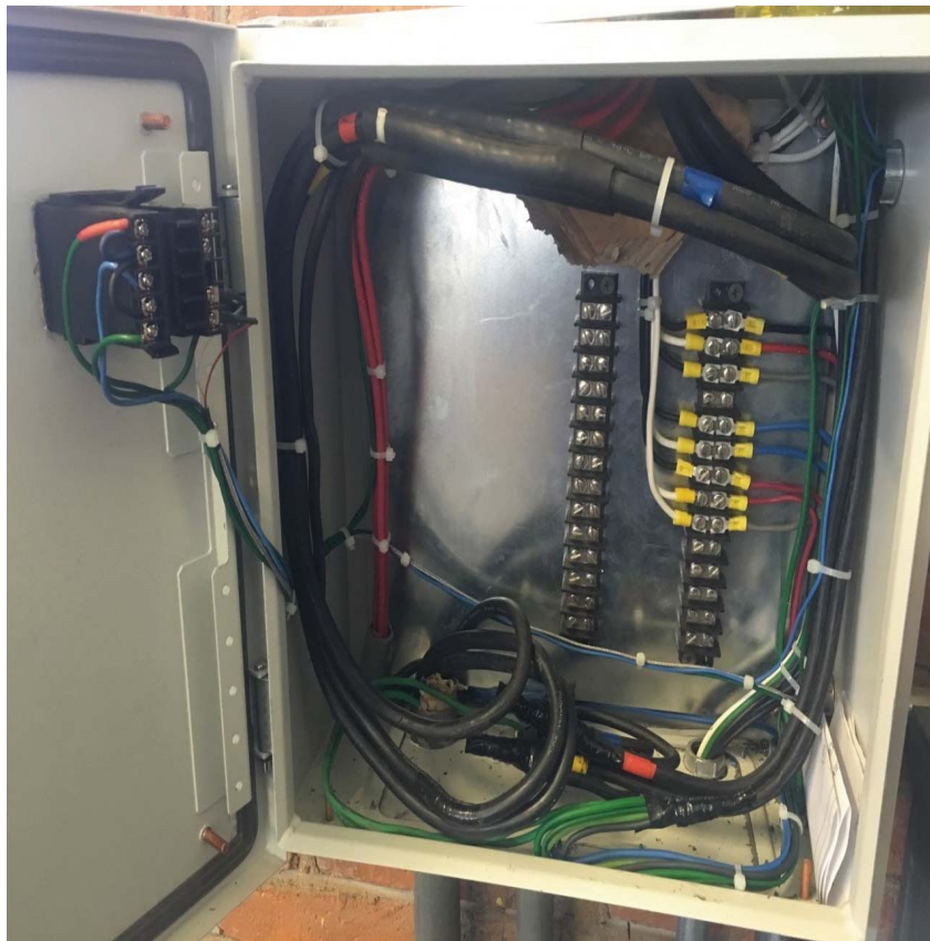
Fig. 43 PLC conectado al sensor de temperatura y extractor de aire
