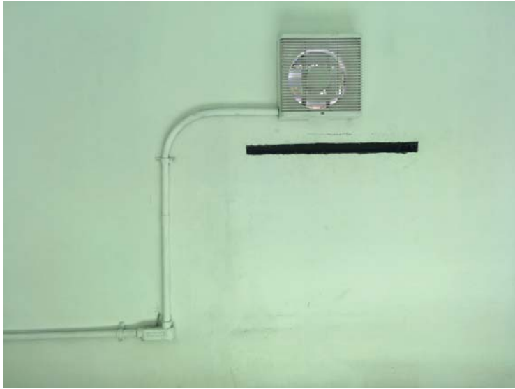
Fig. 42 Extractor de aire
